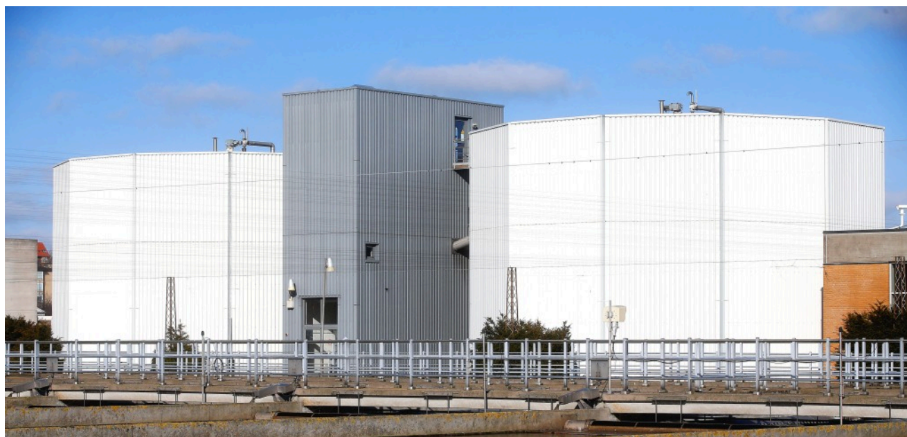
Marselisborg Renseanlæg rådnetårne til energiproduktion. Foto: Aarhus Vand
