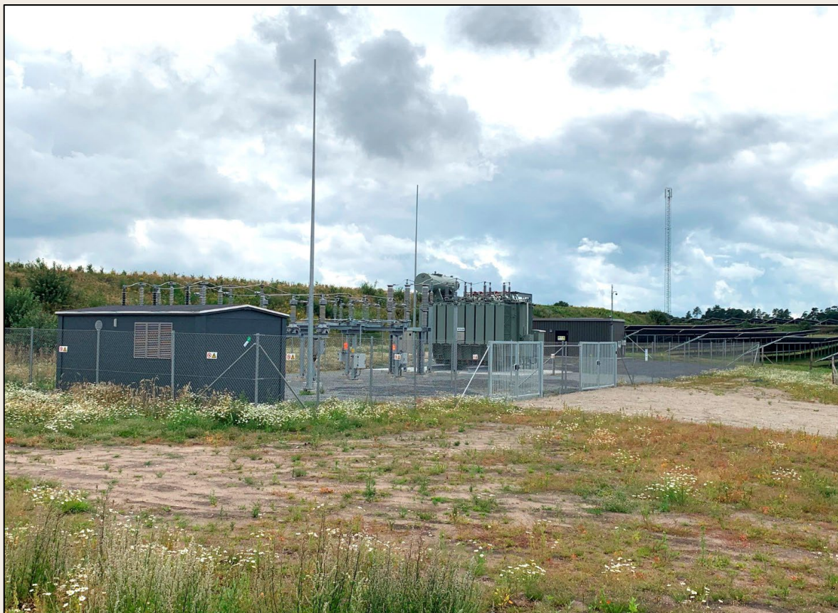
Billede 6: Eksempel på transformerstation.
