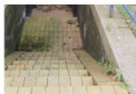
Trin og trinflader ved kælnedgange udføres i oprindelige proportioner, udtryk og materialer.
